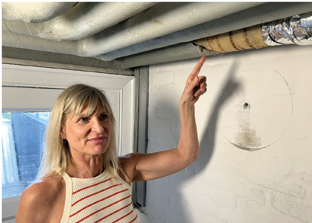
Beboer Pia Kolze viser de rør frem i kælderen, som måske indeholder asbest. De stod åbne i månedsvis, fortæller hun og en anden beboer, Bjarne Jørgensen, der viser rundt i ejendommen.
