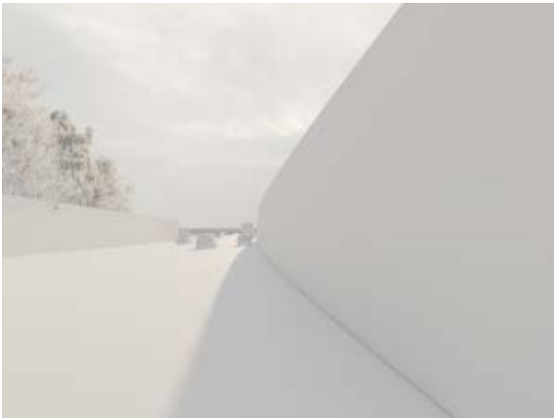
5. Med støjskærm der anbefales fjernet.
