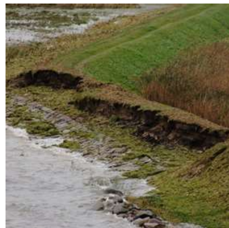
Billede 1: I oktober 2023 blev Sydjylland ramt af en stormflod, som var tæt på at medføre digebrud pga. alvorlige skader på diget.
